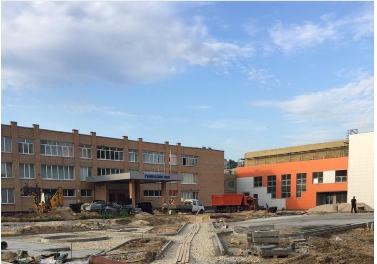
Общий вид строящегося объекта (пристройка к зданию МАОУ «Гимназия № 9», г.о. Королёв, Кооперативная, д. 1)
